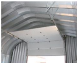
パネル接続部
